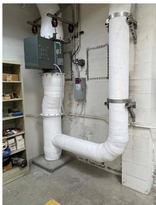
New Exhaust Fan System.
